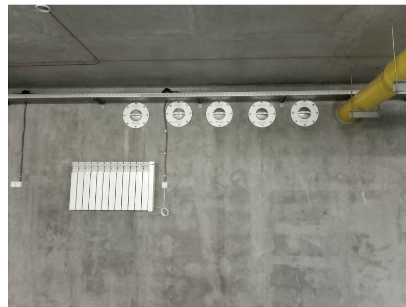
BVNC 300 8Y в захисній споруді
